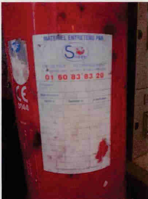
extincteur non vérifié
