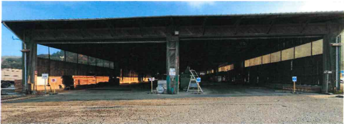
Figure 2: hall de traitement, au centre se situent l'installation de trempage et le stockage des produits de préservation. Le sens de circulation est précisé par des panneaux.
