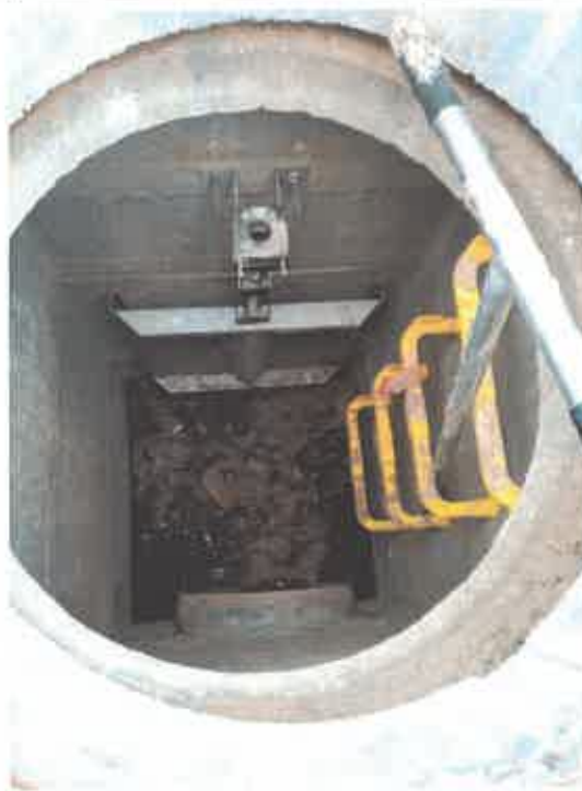
PHOTO 2 : vanne d'isolement entre le bassin du site et celui de la zone industrielle
