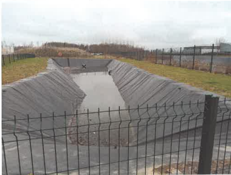
PHOTO 1 : Bassin réalisé à l'est du site – double usage (eaux pluviales et confinement des eaux d'extinction)
