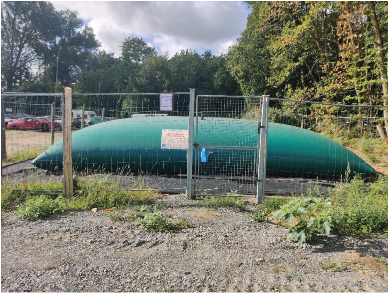
Deux réserves à incendie
