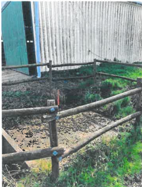
Fosse de récupération des eaux blanches et vertes non sécurisée.
