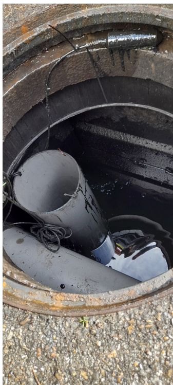
Figure 2: Séparateur saturé en Hydrocarbures
