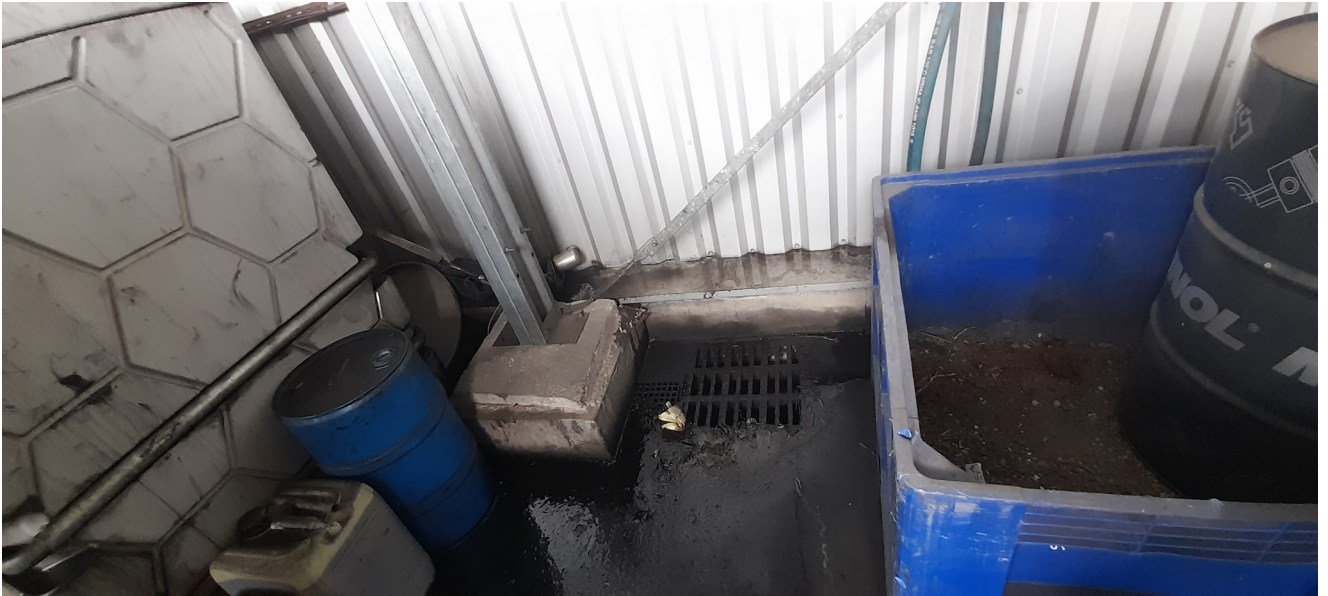
Figure 4: Local des cuves de collectes des fluides issus de la dépollution des VHU : évacuation à obturer
