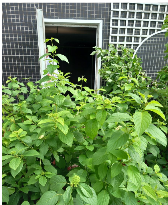
Sortie de secours
