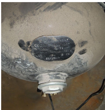
Plaque constructeur de la cuve du compresseur
