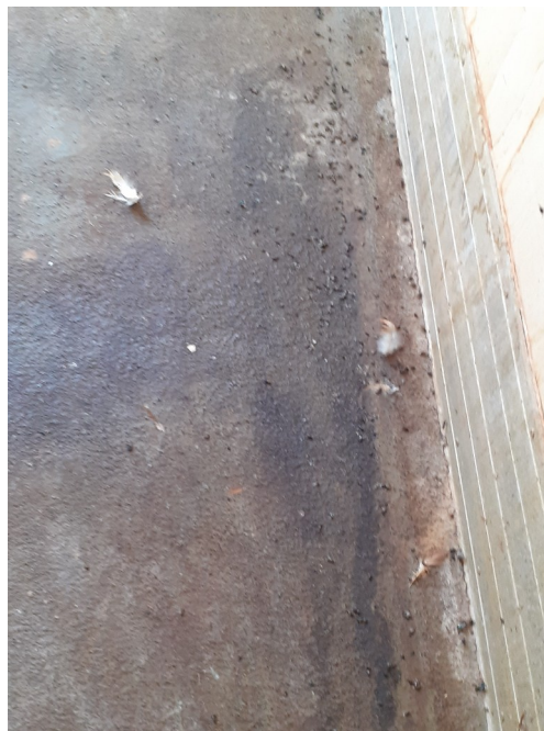
de jus séché et mouches mortes au sol du caisson de stockage
