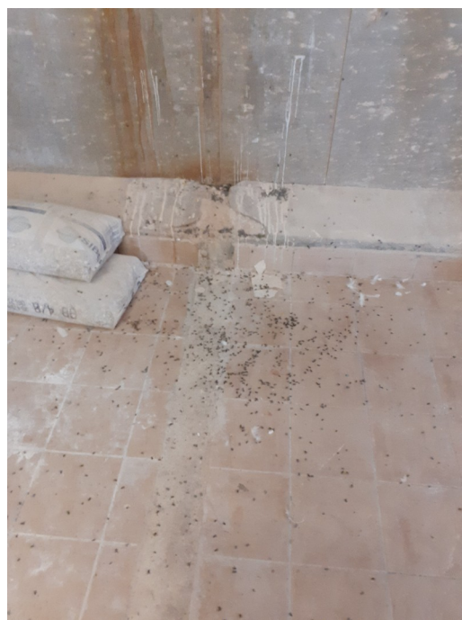
Mouches mortes au sol dans le sas du bâtiment B5
