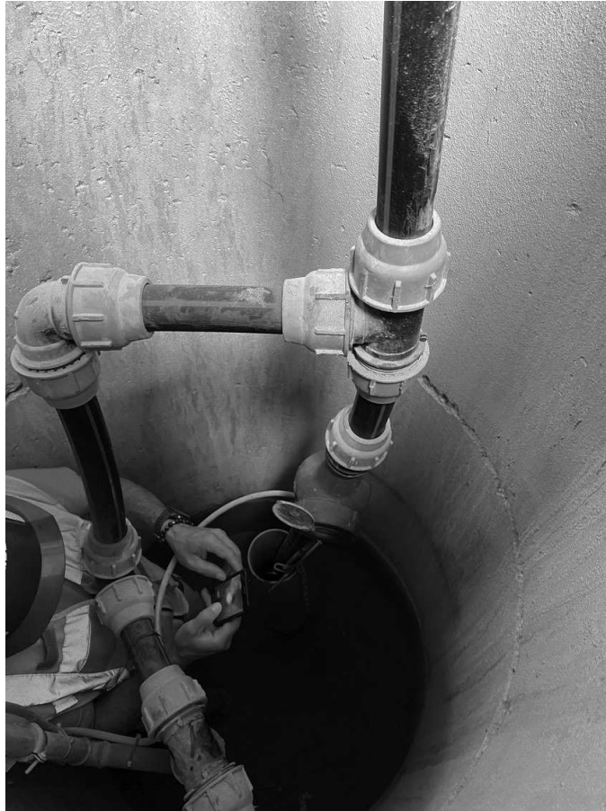
Compteur et pompe immergée
