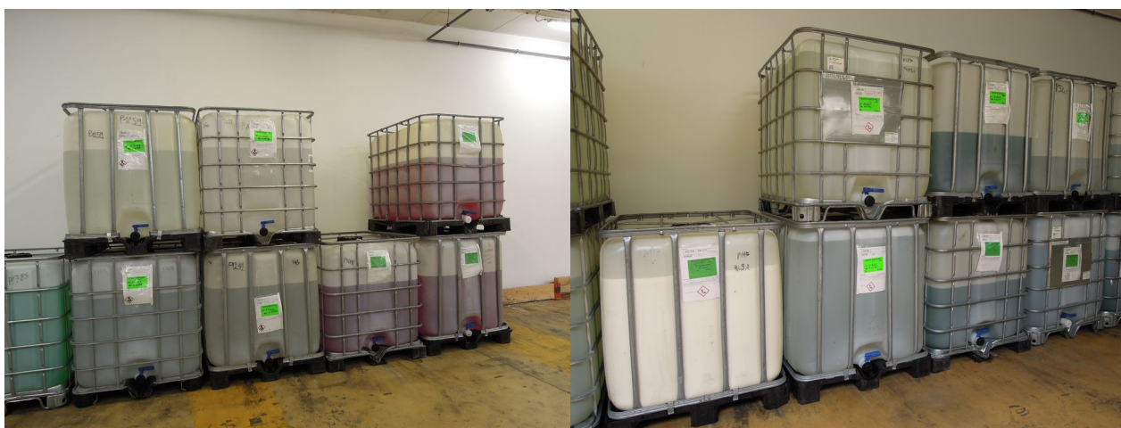
Isoconteneurs de produits classés dangereux stockés sur le sol de l'atelier sans rétention.
