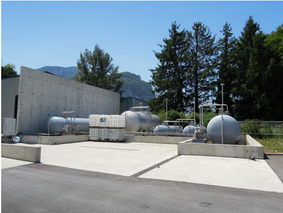
Réservoirs extérieurs de stockage de liquides inflammables
