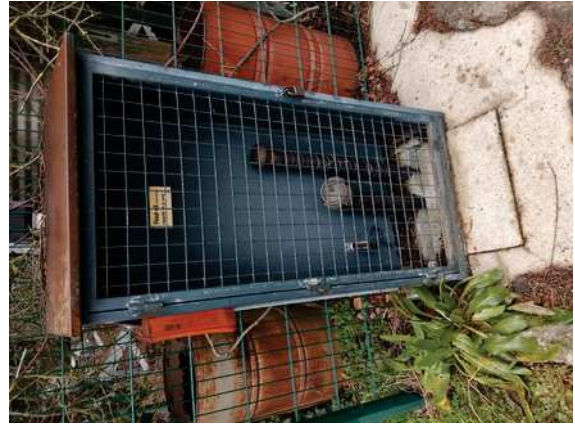
Aire grillagée et dépotage fioul
