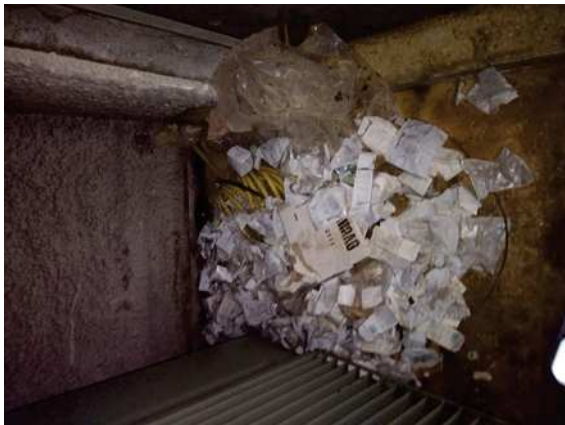
Local du groupe électrogène de cogénération
