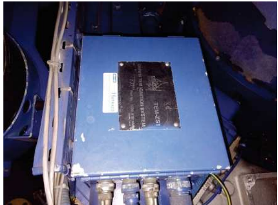
Local du groupe électrogène de cogénération
