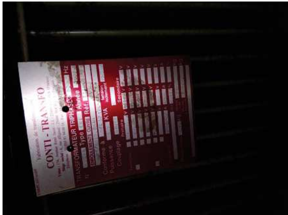
Local du groupe électrogène de cogénération
