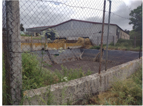
Photo 5 Fosse géomembrane avec grillage
