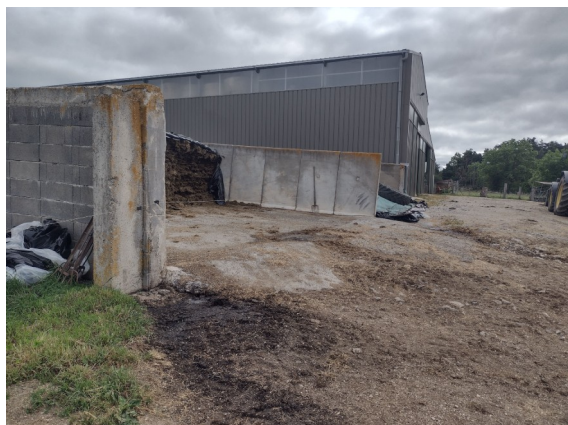
Photo 3 Jus de silos non collectés, absence de déversoir d'orage
