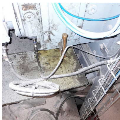
Suintements d'huile au niveau des moteurs des rouleaux du pied de four n°3
