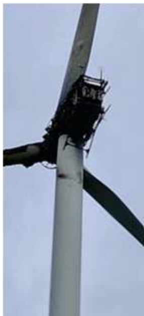
éolienne E09 accidentée
