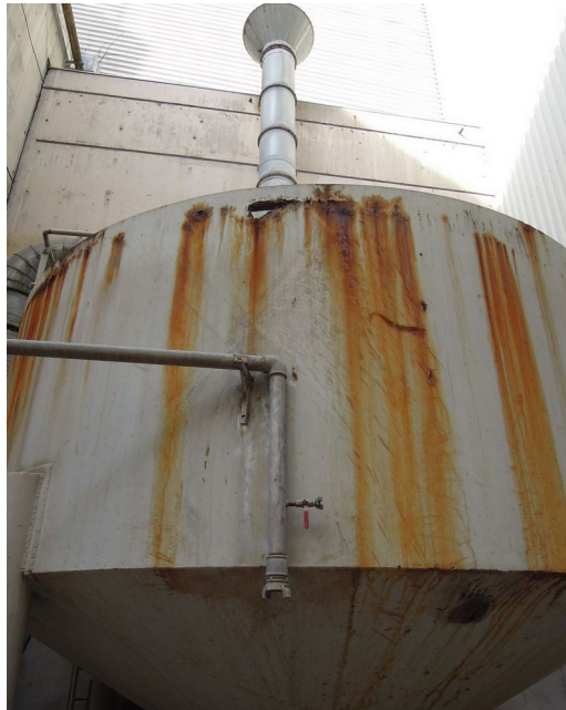
Corrosion perforante observée sur la robe du décanteur
