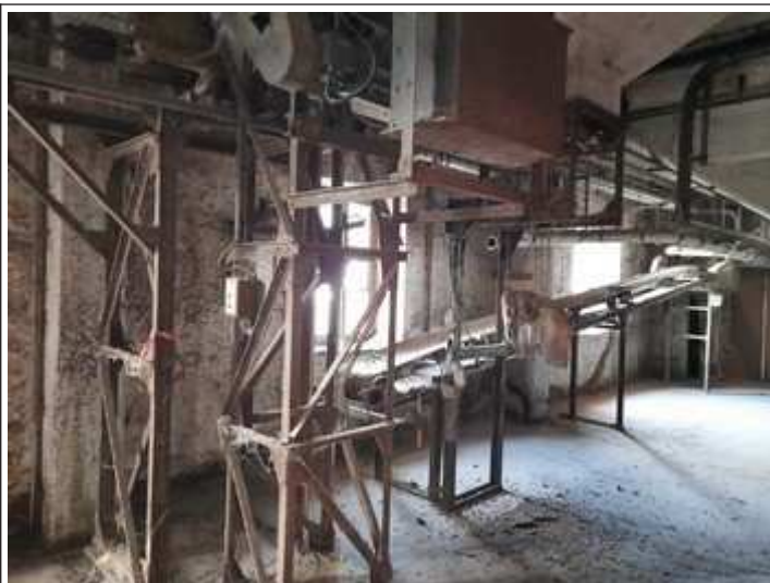
Cf point 11 : Base du boisseau pellet (déconnexion électrique)
