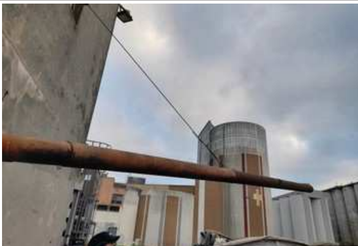
Cf point 21 : Tuyau extérieur d'évacuation des boues non isolé
