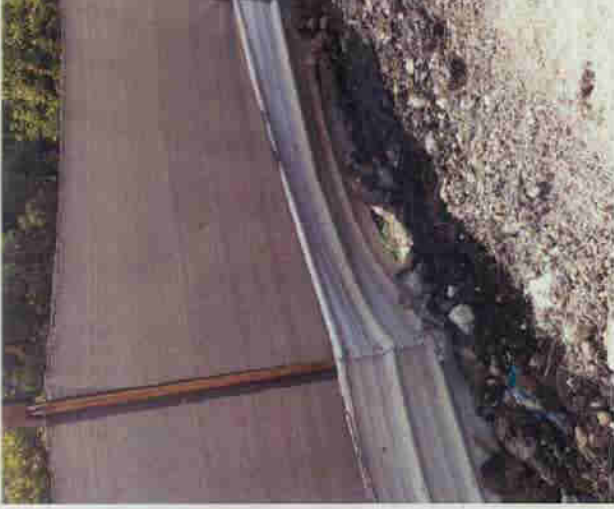
P2 : Panneau gondolé sous le poids des déchets et trou sous la clôture
