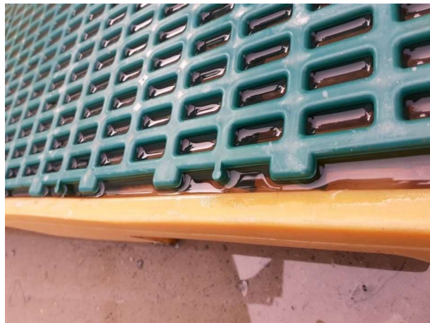
Rétention pleine d'eau de pluie
