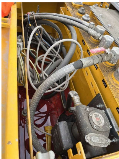
Récupération d'égouttures (à pomper/ nettoyer)
