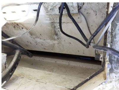
Cuve sans récupération d'égoutture (après pompage)
