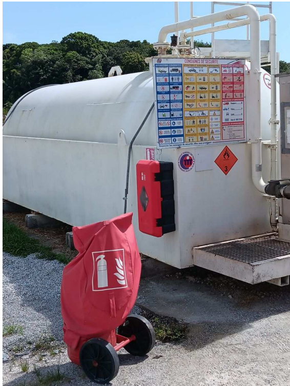
Cuve sur rétention
