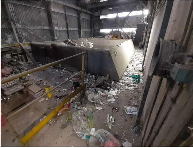
Zone d'injection des OM dans le four
