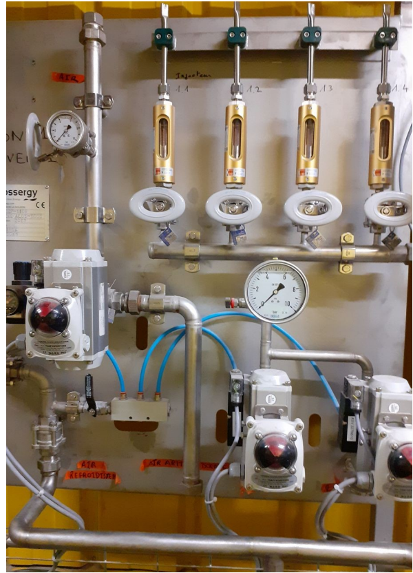
Séparation des zones d'injection d'ammoniaque au niveau du four
