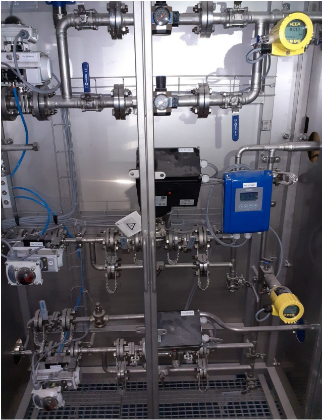
Skid du dosage d'ammoniaque en amont du four
