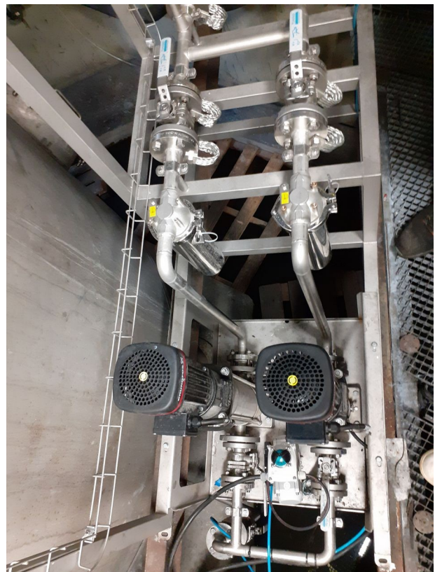
Nouvelles pompes du réseau d'ammoniaque
