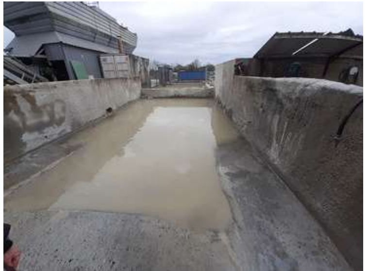
Bassin de décantation
