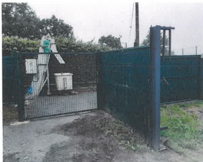
Zone mal entretenue et souillée aux abords du dégrillage :
