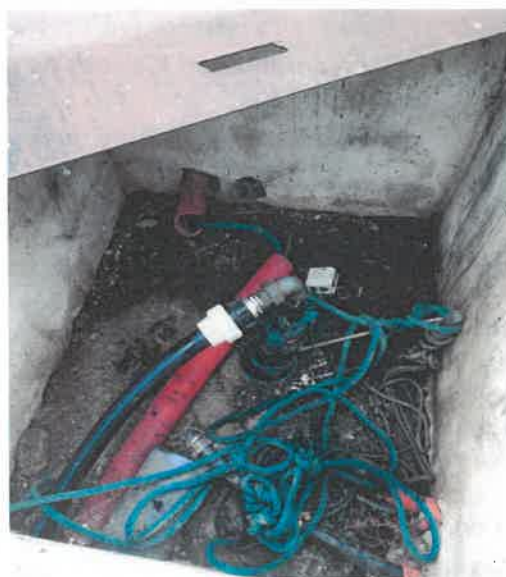
Puits de prélèvement du forage F2 :
