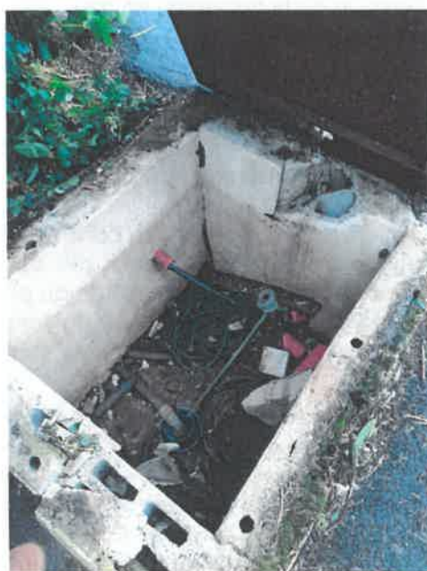
Puits de prélèvement du forage F1 :
