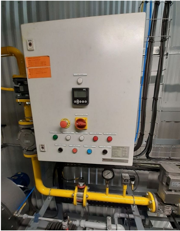
Armoire électrique des conduites de gaz naturel
