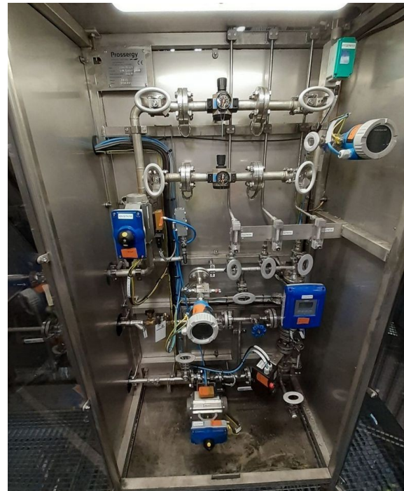
Armoire d'injection d'ammoniaque
