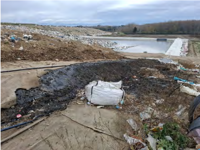
Diguette endommagée au sud du casier C'8
