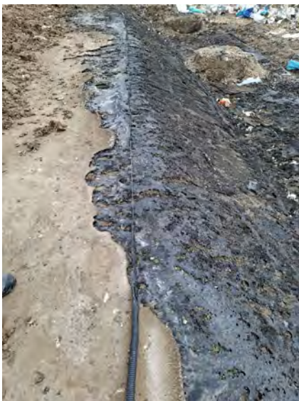
Câble électrique endommagée (pompe lixiviats)
