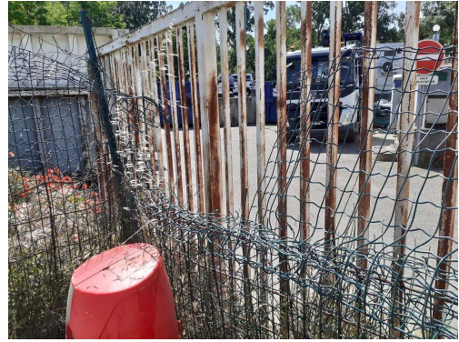
Trou dans la clôture
