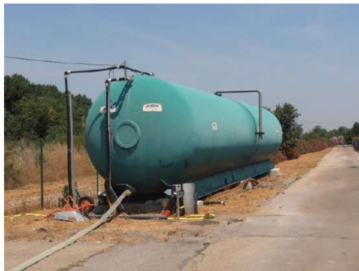
Figure 1-25 : Cuve de récupération des eaux du bio-filtre
