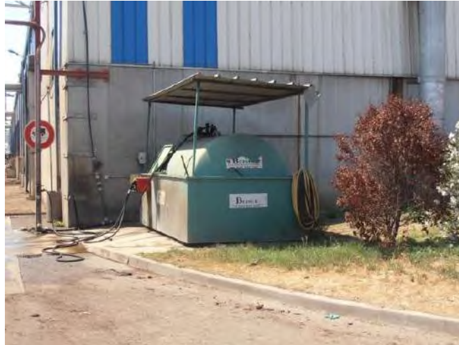
Figure 1-2 : Pompe de distribution et cuve GNR
