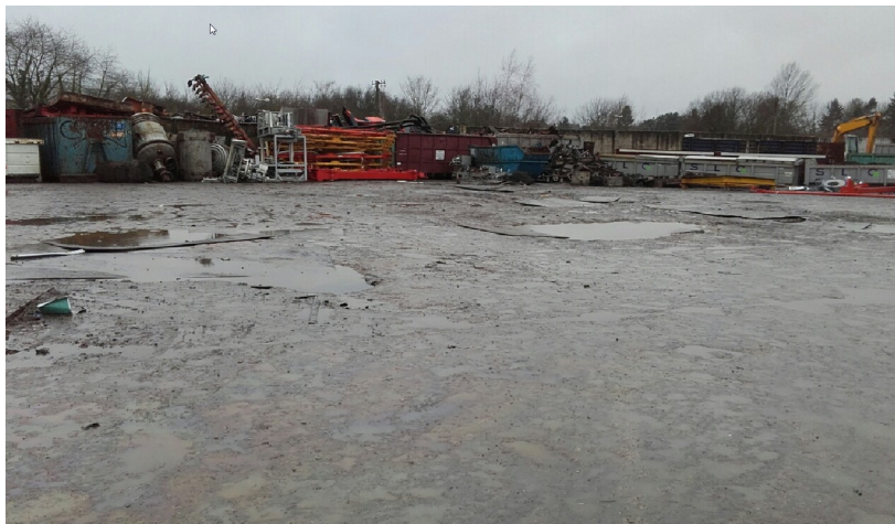
Photographie des dégradations de la dalle prise le 31 janvier 2018
