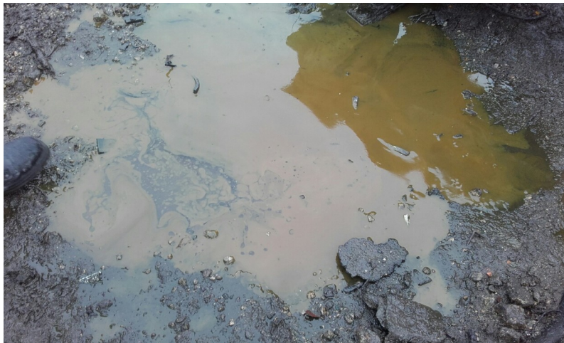
Photographie d'une partie dégradée retenant des eaux pluviales et contenant un surnageant de type huile hydraulique
