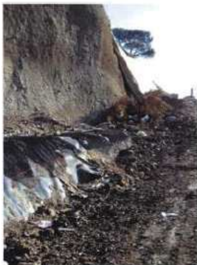
Figure 22 : Perforations de la géomembrane au niveau du talus est du casier 2 (14 décembre 2005)
