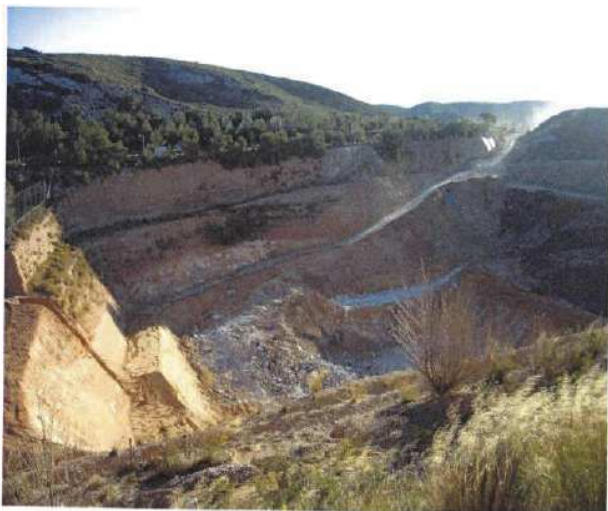
Figure 8 : Vue des excavations et terrassements de fond réalisés au niveau du casier 3 (21 janvier 2005 en haut et 4 février en bas)
