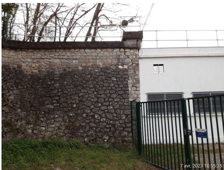
Figure 13: Fissuration des ouvrages de soutènements autour du réservoir de la rue des Deux Rocs.
