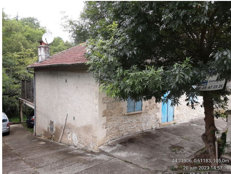
Figure 5: Maison présentant des fissures (voir détail montrant les fissures avec témoins de déformation) pouvant être liées à des déformations du sol en bordure du ruisseau de Courbarieux.
