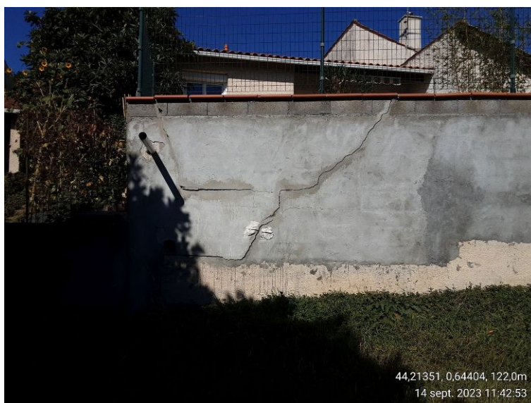
Figure 15: Mur de soutènement avec désordres (rue de Touapse).
