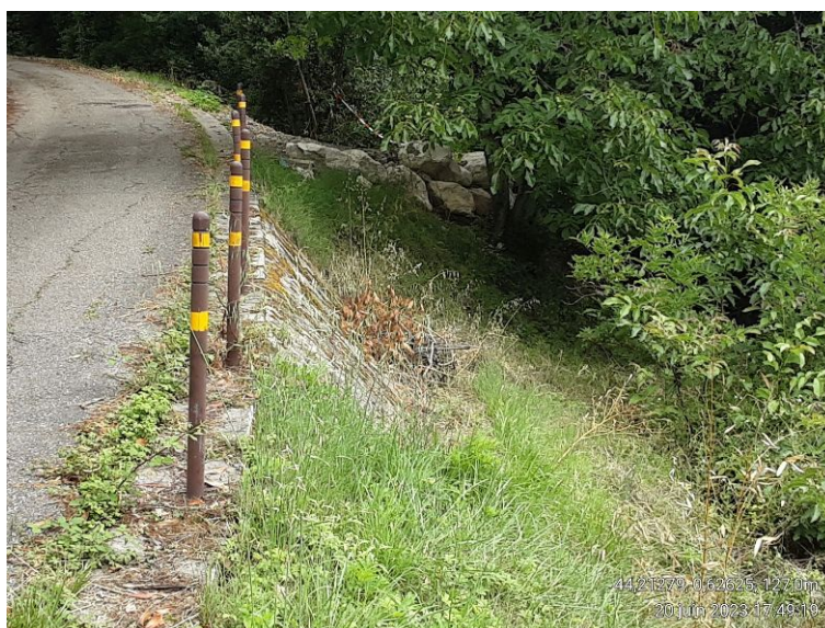
Figure 8: Ouvrage de soutènement rue Fouyte-Porc. Cet ouvrage a probablement été mis en place à la suite d'un glissement ponctuel.
