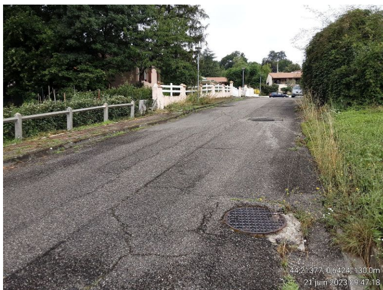
Figure 14: Déformation et fissuration de la voirie (Impasse Goethe).
