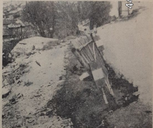
Le 10 avril 1962, la route venait d'être remise en état, mais le glissement était loin d'être stabilisé, et de nouveaux désordres se produisaient.
