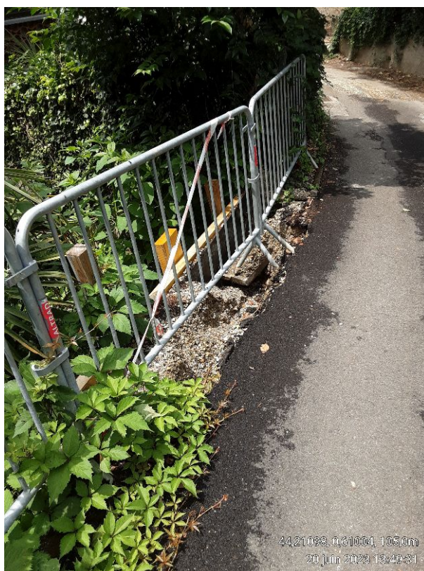
Figure 4: Instabilité du talus aval de la Rue de Prouchet.
