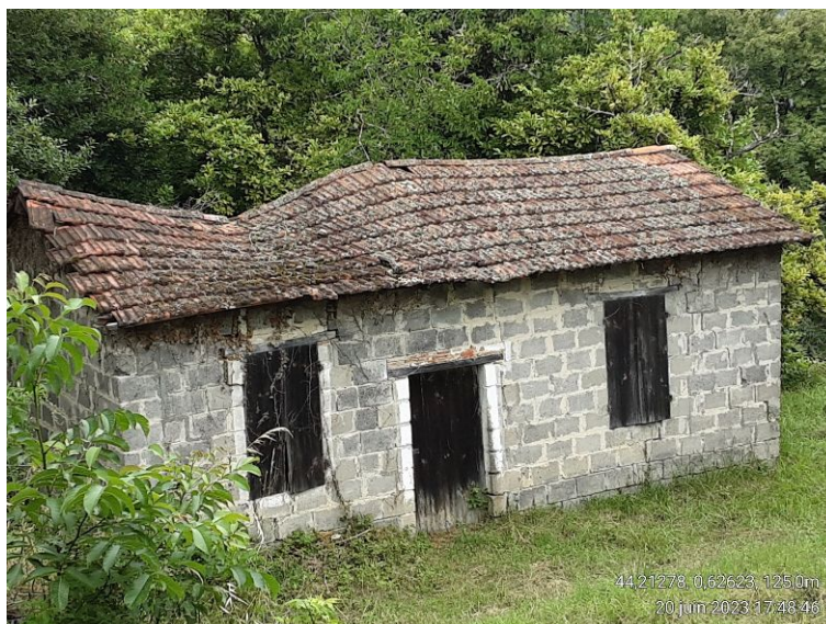
Figure 7: Petite construction en contrebas de la rue Fouyte-Porc, avec une importante fissuration et des dénivellations sur les terrains avoisinants.
