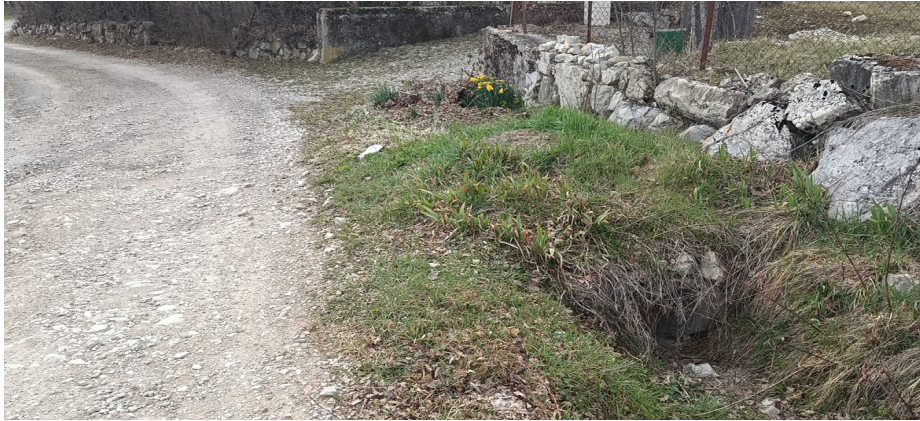
Buse sous dimensionnée à l'amont du village – Ravin des Faysses
