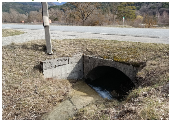
Demi-buse métallique franchissant la D1075 – présence de matériaux dans la buse : obstruction partielle
