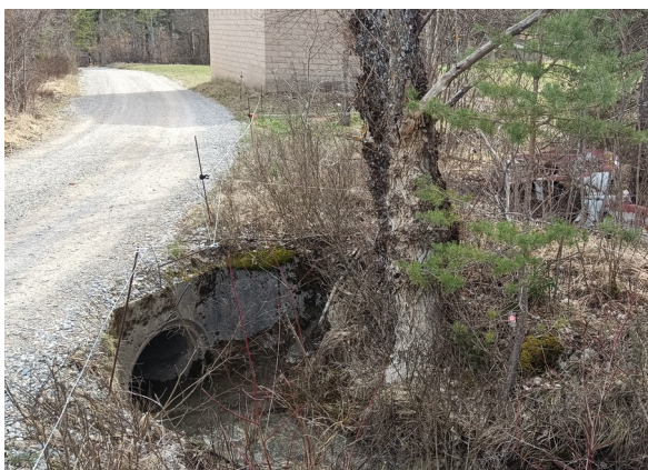
Buse sous-dimensionnée franchissant la piste située à 360 m à l'amont de la RD
