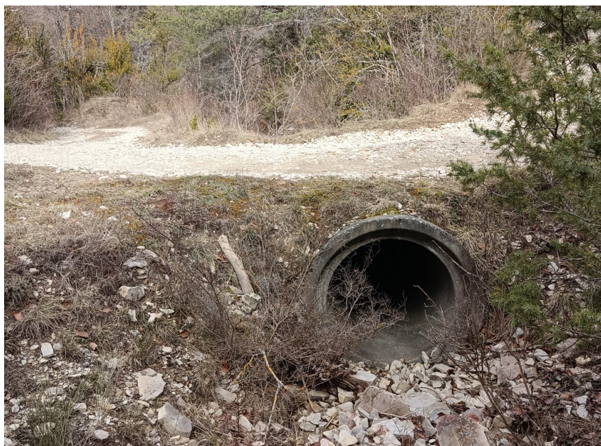
Buse phi 800 mm sous-dimensionnée susceptible de s'obstruer en cas de crue au niveau de la piste – à 100 ml à l'amont des enjeux
