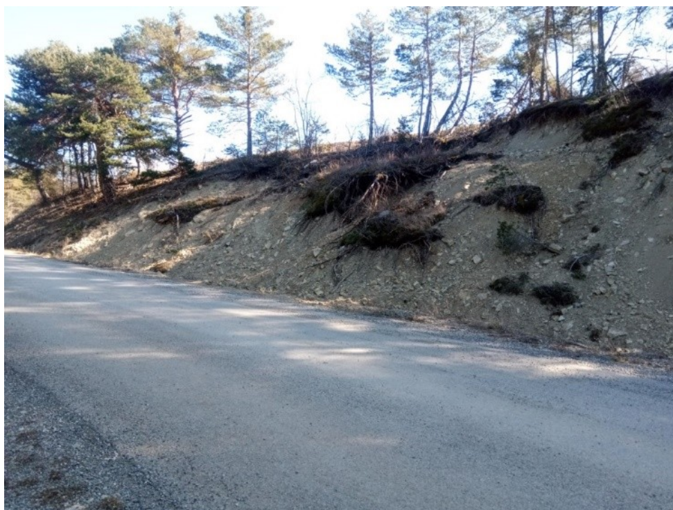
Talus de route menant au hameau de Seille, source ONF-RTM
