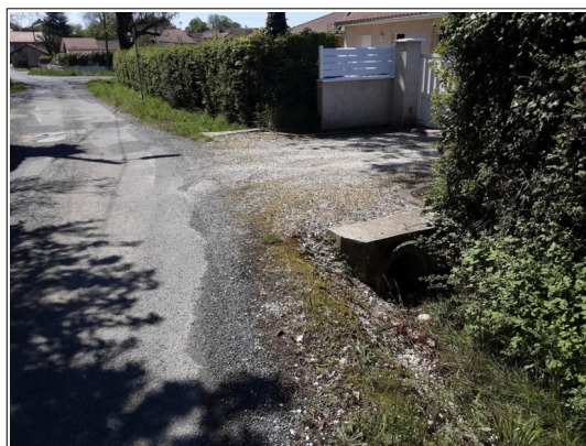
Figure 9: point bas inondable dans le hameau de Turgon (commune de Druillat) situé en continuité d'un axe de ruissellement;
