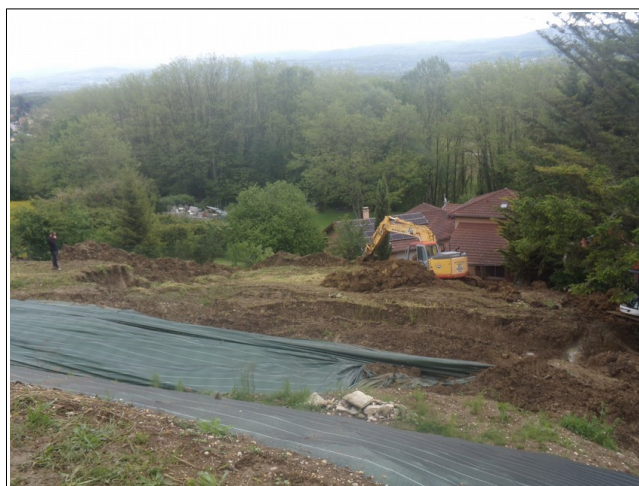
Figure 11: glissement de terrain sur la commune de Villette-sur-Ain en aval du chemin de La Dombes (printemps 2021).
