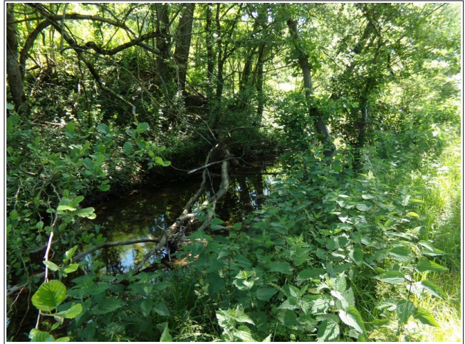
Figure 3: branchages encombrant le lit mineur du ruisseau du Durllet (commune de Druillat) pouvant causer des embâcles.
