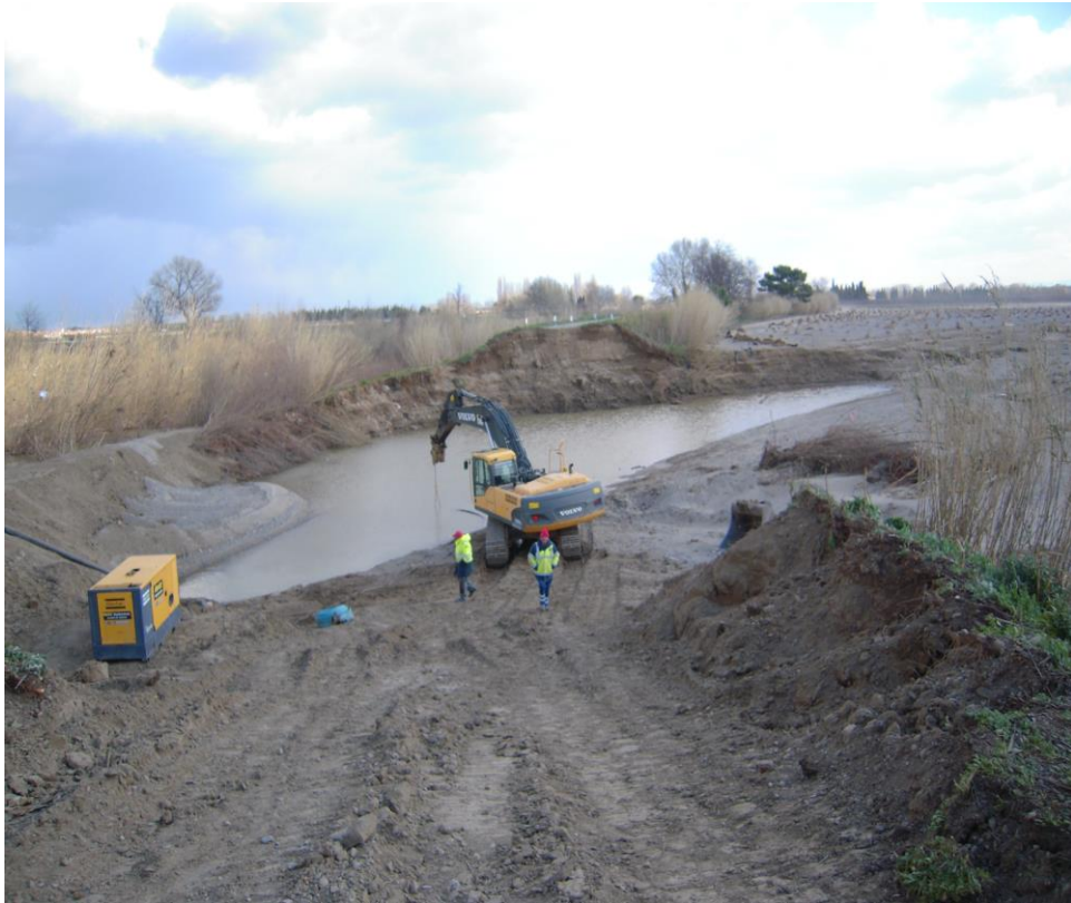
Brèche sur l'Agly au niveau de la commune de Pia en mars 2013 (photo DDTM66)
