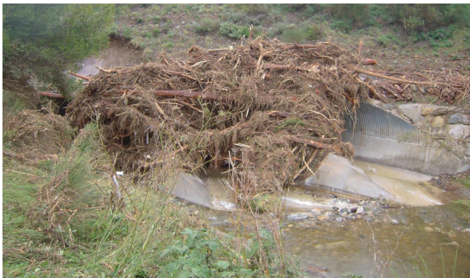
Buses sur le ravin Le Ravaner - commune d'Argelès sur mer sous la RD 914 - novembre 2014
