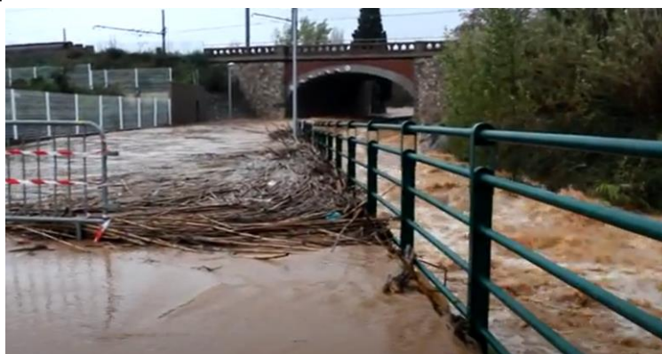
Crue de la Llobère à Rivesaltes (Voie ferrée) – Novembre 2014
