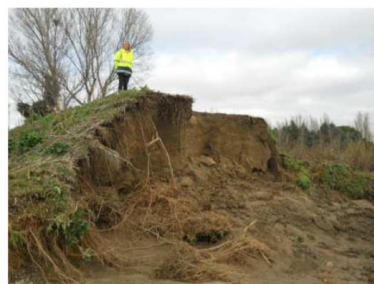
Brèche de 2013 à Pia
