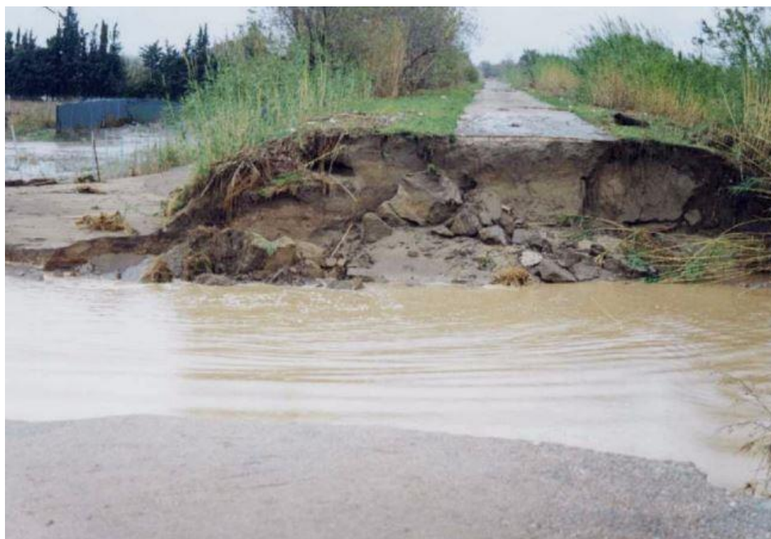
Brèche sur l'Agly à Saint-Laurent-de-la-Salanque lors de la crue 1999
