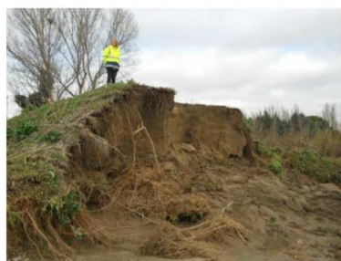
Brèche de 2013 à Pia
