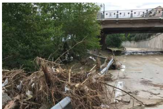
Illustration 45 : Berges de la Têt suite à la crue de janvier 2020
