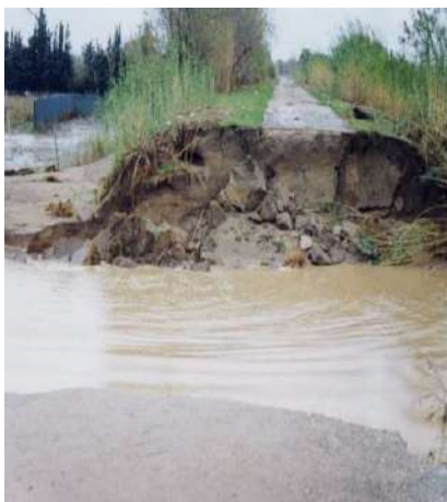
Illustration 10 : Brèche sur l'Agly à Saint-Laurent de la Salanque lors de la crue 1999 (photo DDTM66)
