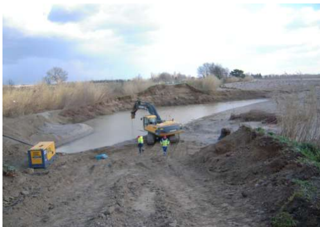
Illustration 11 : Brèche sur l'Agly au niveau de la commune de Pia en mars 2013 (photo DDTM66)
