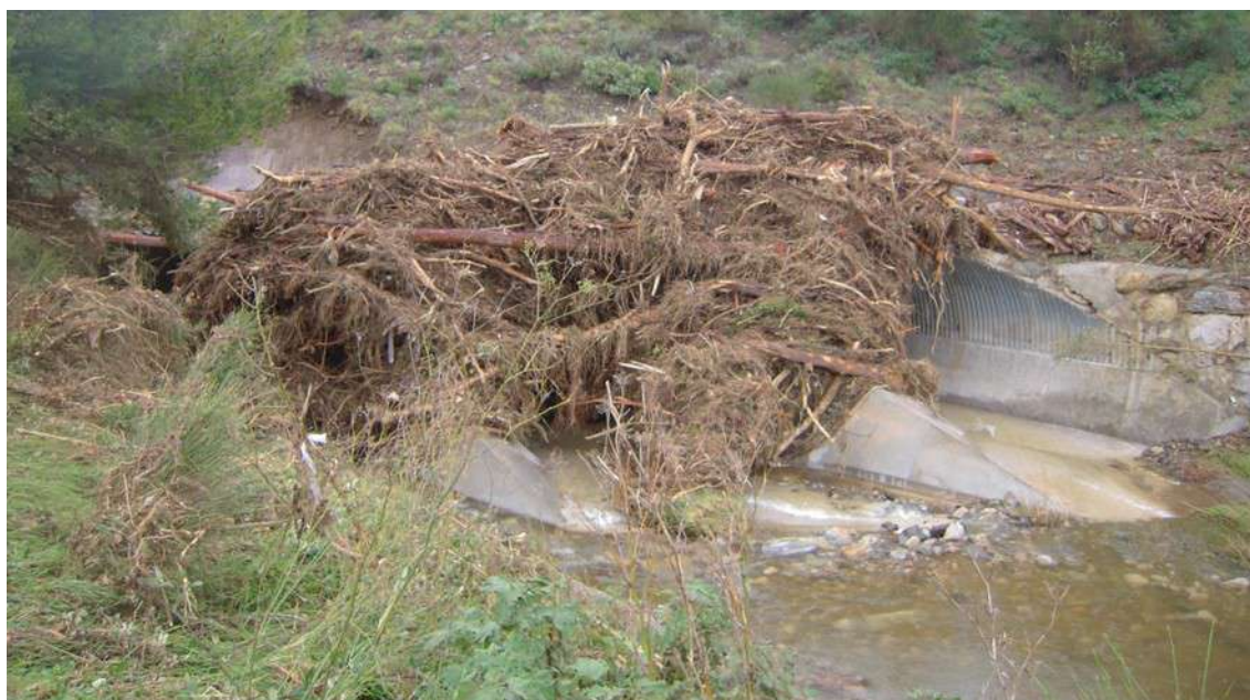
Illustration 14 : Buses sur le ravin Le Ravaner - commune d'Argelès sur mer sous la RD 914 - novembre 2014
