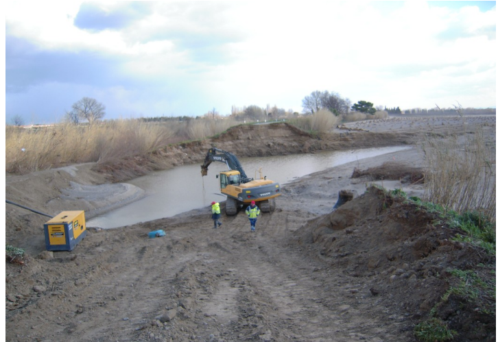
Illustration 6 : Brèche sur l'Agly au niveau de la commune de Pia en mars 2013 (photo DDTM66)
