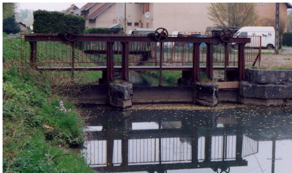
Vannes d'entrée du canal des FORGES
