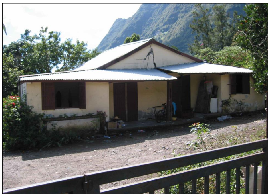
Figure 19 : Conséquence sur le bâti – exemple d'une maison dans l'emprise du glissement de Mare à Goyaves
