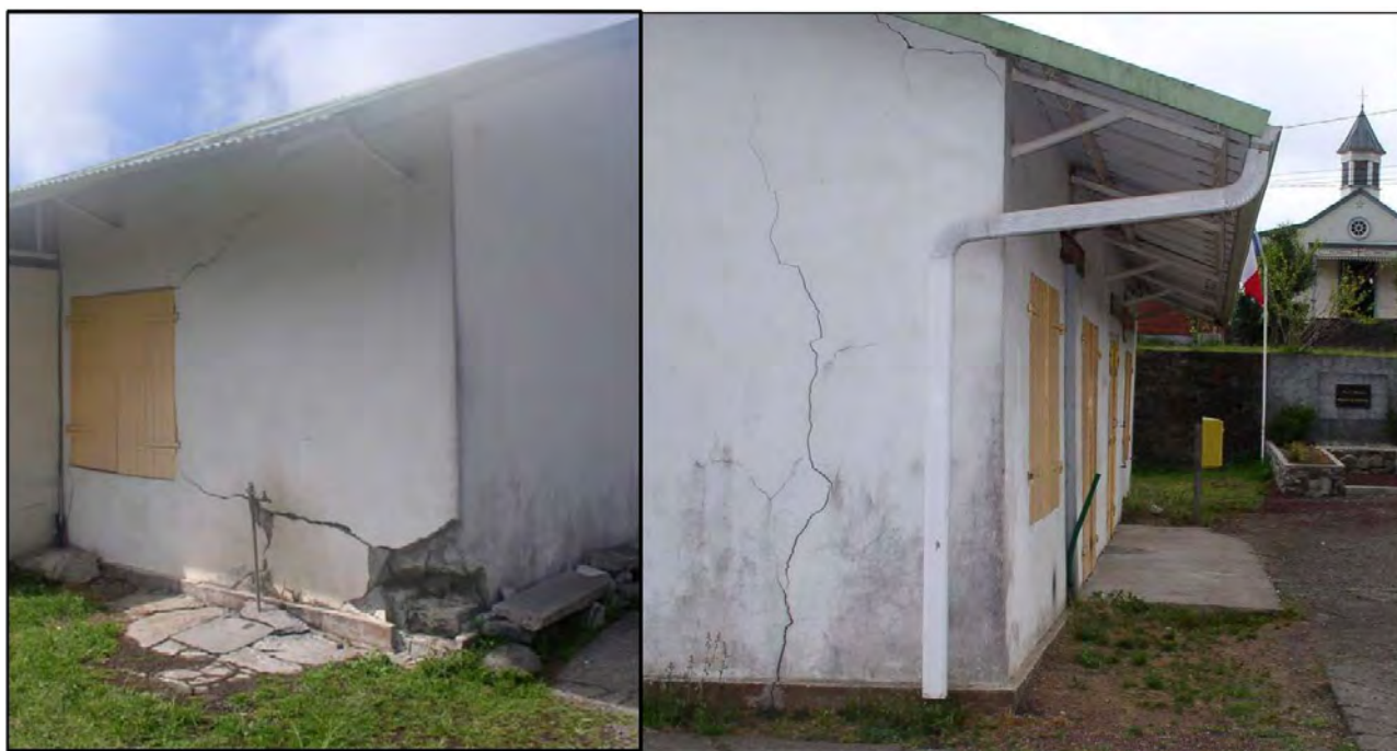
Figure 17 : Désordre sur le bâtiment abritant l'ancienne Poste de Grand Ilet (Garnier, 2008)
