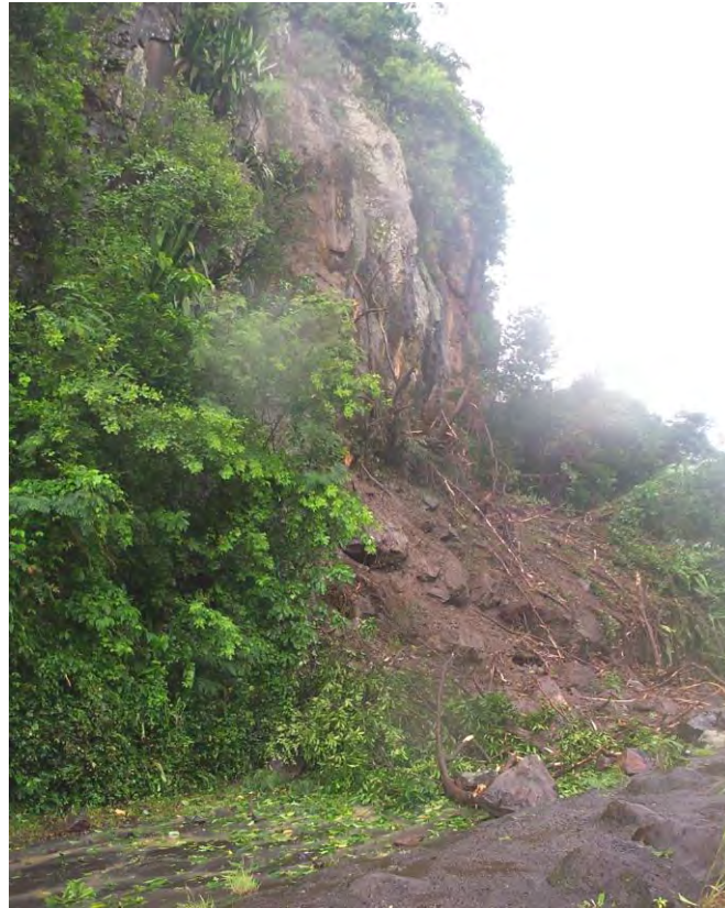
Figure 20 : Éboulement (volume total de 10\text{m}^3 ) survenu le 18/02/2005 sur la falaise Moka
