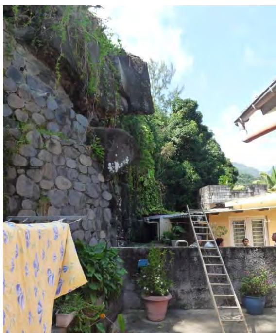
Figure 18 : Bloc de plusieurs m 3 menaçant une habitation située au 119 Chemin Moka
