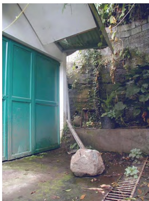
Figure 19 : Chute d'un bloc d'une vingtaine de litres sur la maison N° 107 (début mars 2001)
