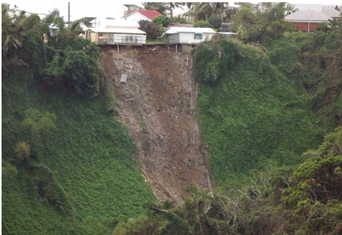
Figure 25 : Glissements de terrain affectant deux parcelles localisées en rive droite de la Ravine de la Mare (Rue de l'horizon)
