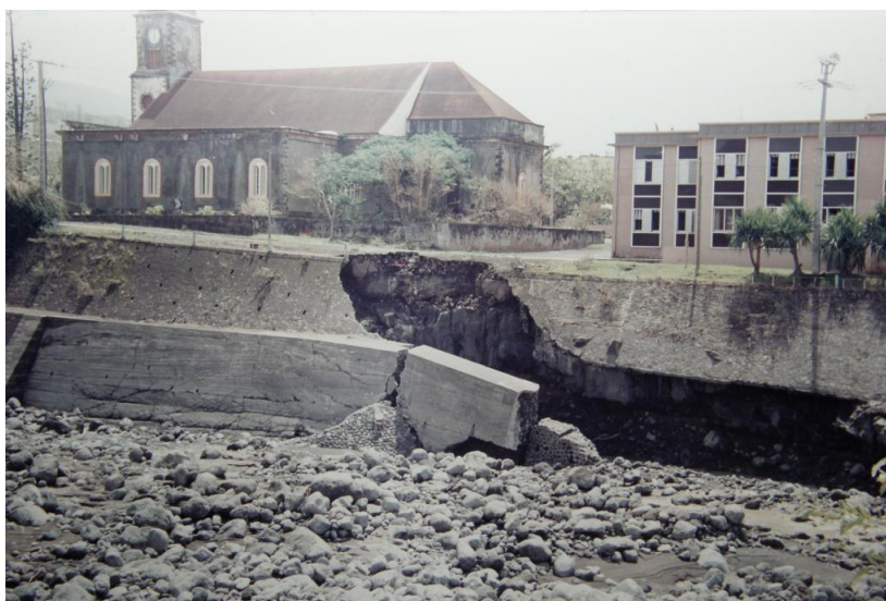
Figure 36 : Dégâts sur la digue de l'hôpital de Saint-Joseph suite au passage de Firinga (1989)
