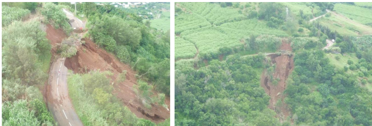
Figure 29 : Glissement de terrain observé sur la RD3 à Saint-Joseph
