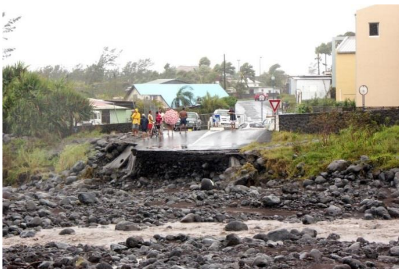
Figure 35 : Dégâts après le passage du cyclone Gamède (2007)
