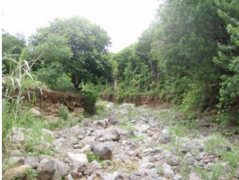
Figure 31 : Erosion de berges - Ravine Jean Petit (2009)
