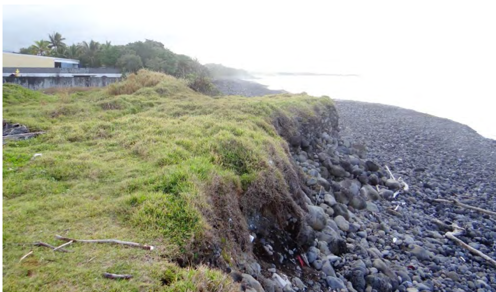
Figure 24 – Talus d'érosion au niveau du cimetière de Sainte-Anne (photographie BRGM, 2013)
