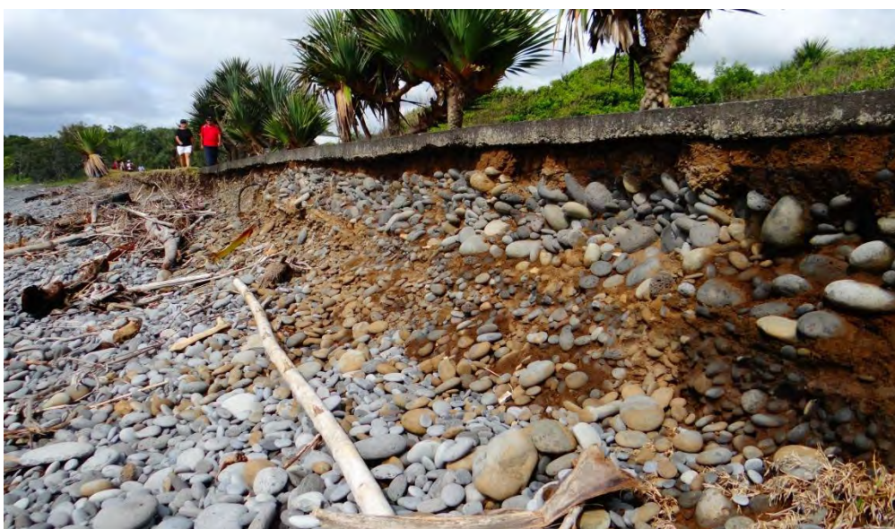
Figure 23 – Erosion du sentier littoral du Bourbier-les-Bas à Saint-Benoît (photographie BRGM, 2013)
