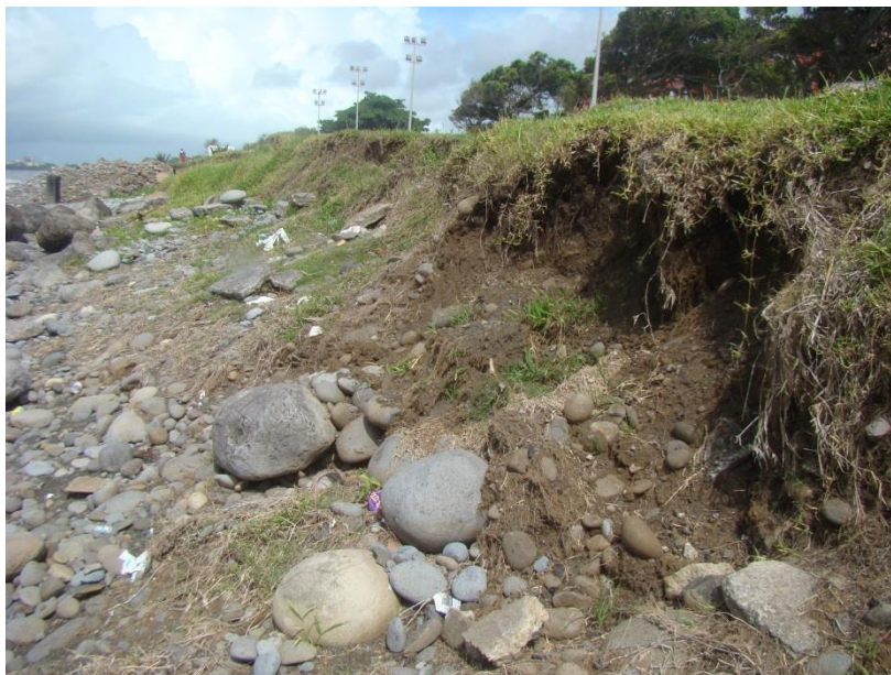
Figure 23 - Erosion récente du talus en haut de cordon de galet proche du centre-ville de Sainte-Suzanne (Rapport OBSCOT, 2013)
