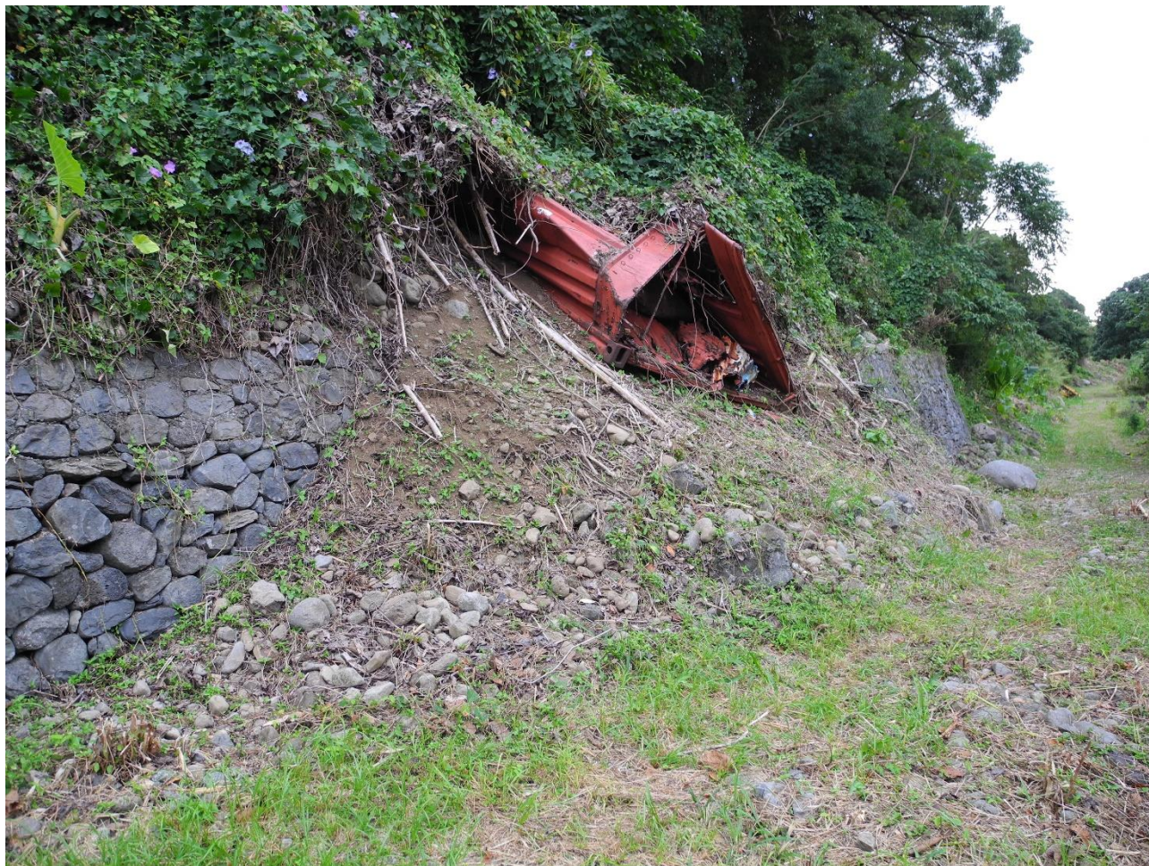
Figure 14 : Glissement de terrain sur un talus au nord du quartier de Paniandy, 2013
