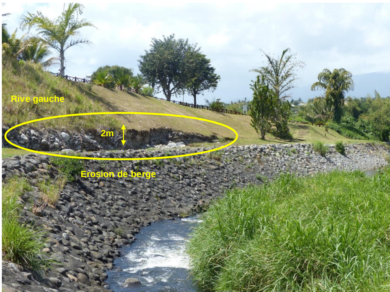
Figure 15 : Erosion de berge suite au passage de la forte tempête tropicale Fakir (2018)
