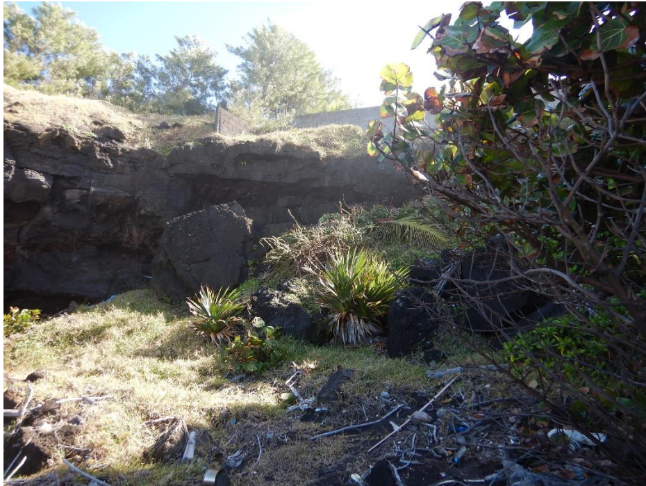
Figure 37 : Sous-cavage de la falaise sur le secteur de Lenepveu, le risque d'effondrement est important pour les enjeux situés au-dessus (BRGM, 2020)
