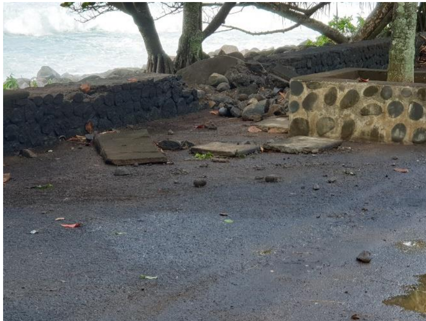
Figure 28 : Dégâts faisant suite aux houles australes d'août 2019 (Photos Mairie de Saint-Joseph)
