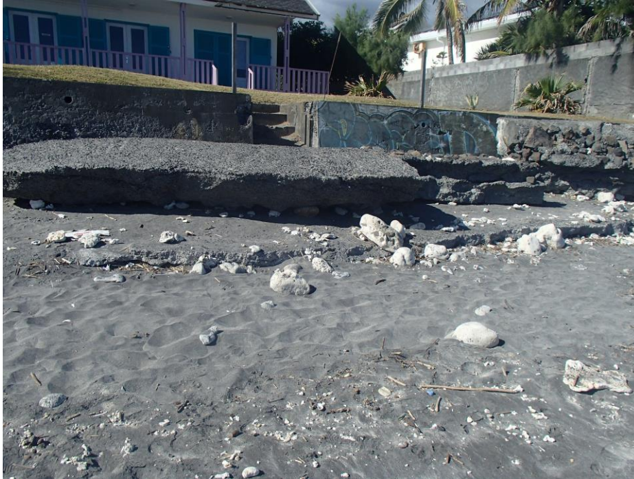
Figure 24 : Exemple d'affouillement sur le secteur de la Souris Blanche à Trois-Bassins
