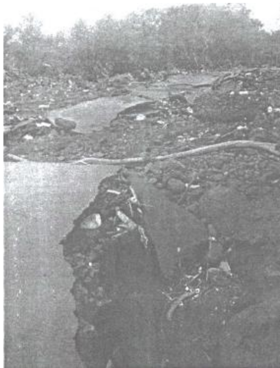
Figure 19 : Chemin de Bassin-Plat soufflé sur plus de 300 m par les eaux de la rivière d'Abord suite au passage du cyclone Clotilda, 1987
