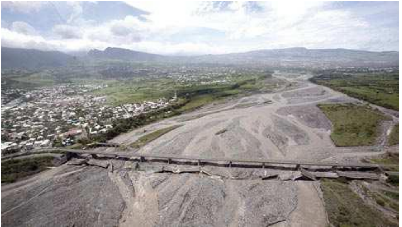
Figure 18 : Destruction du pont aval de la Rivière St Etienne suite aux crues lors du passage du cyclone Gamède en février 2007 (DDE Sud Réunion)
