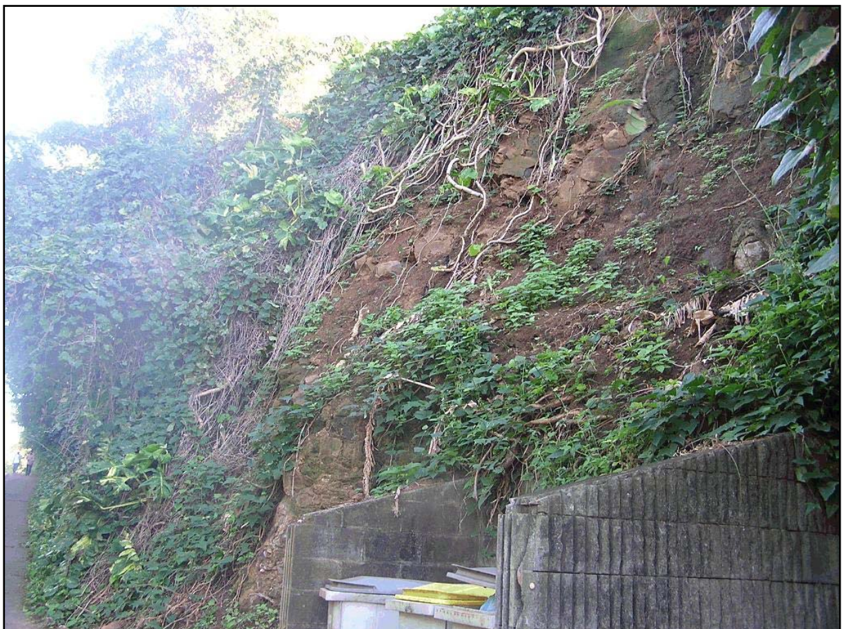
Figure 11 : chute de blocs dans les rampes de Bel-Air, RN2002 (2004)
