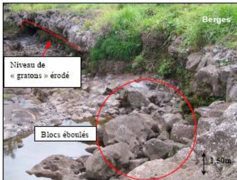
Erosion de berge (sous-cavage de « gratons ») au niveau de la Ravine Sèche
